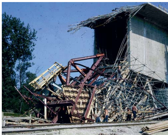
Eine Auflageschiene der Schalungskonstruktion versagte während der Bauarbeiten an der Donaubrücke.
